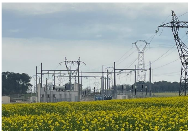
Figure 13 : Poste de Pluvigner existant. Source : TBM.
